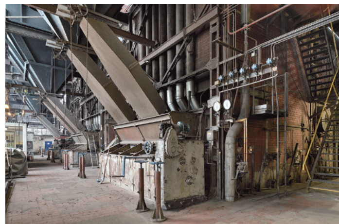
Opava-Vávrovice, kotelna se dvěma kotli z n. p. Tatra Kolín z roku 1952 (č. 1 a 3) a jedním z ČKD (č. 2), po vybudování plynové kotelny v roce 2025 odstavená z provozu. Foto Roman Polášek, 2023
