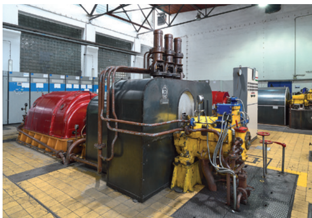
Opava-Vávrovice, strojovna, turbosoustrojí TG1 a TG2, sestávající z generátoru (neznámé datace a původu) a z protitlakové parní turbíny První brněnské strojírny z roku 1956 o výkonu 2,5 MW (TG 1) a z roku 1950 o výkonu 1,6 MW (TG 2), v roce 2025 odstavené z provozu. Foto Roman Polášek, 2023
