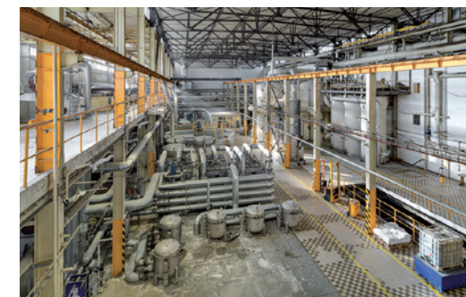
Hrušovany nad Jevišovkou, hala tzv. surovarny II se změkčovací stanicí šťávy (v popředí) a odparkami (vpravo). Foto Roman Polášek, 2023
